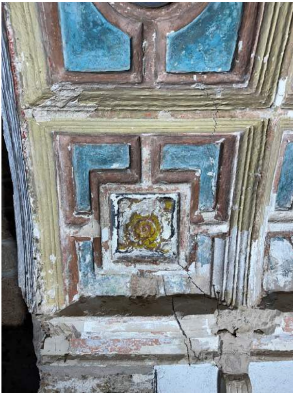
Detall d'un cassetó un cop efectuada la neteja superficial i la fixació de la capa pictòrica.
