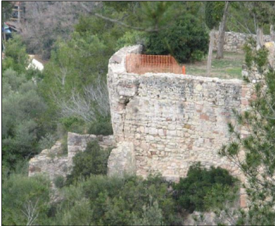
Figura 4. Estat del mur abans del primer esfondrament (A. Mauri)
